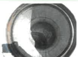
汚水の溜まっていない公共ます
