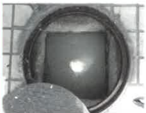
汚水の溜まった公共ます
